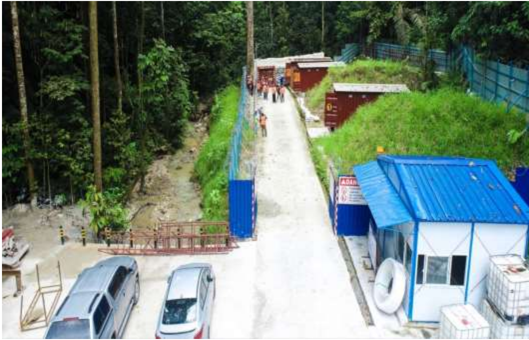
Gambar 9: Magazim mudah alih untuk menyimpan bahan peledak dan bahan letupan yang diasingkan dengan ban tanah (earth bund). Magazim tersebut dikelilingi dengan pagar keselamatan dan terdapat rumah pengawal di pintu masuk kawasan magazim
