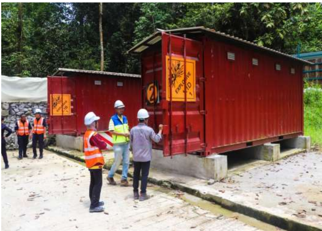
Gambar 10: Magazim mudah alih untuk menyimpan bahan peledak (1.1 B dan 1.1 D) dibina di atas rasuk konkrit (concrete beam)
